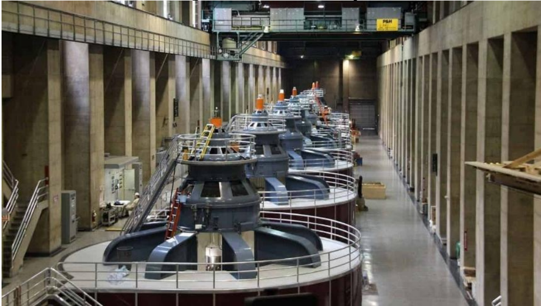
Figura 11 - Casa de Força
