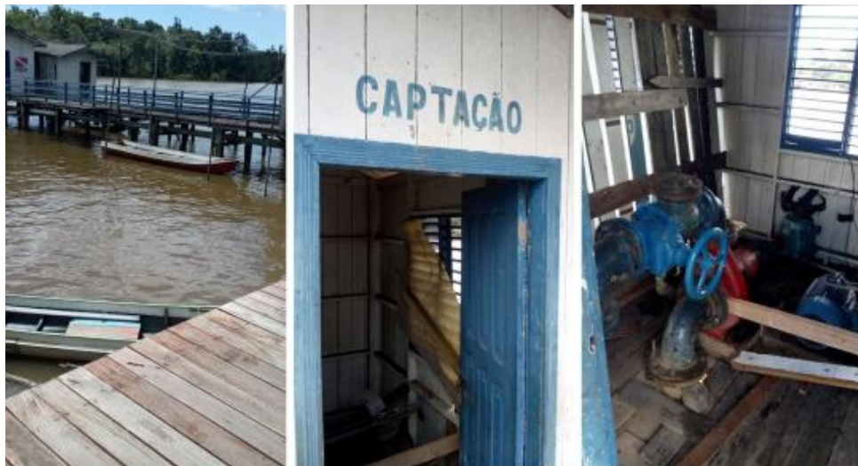
Figura 22: Sistema de Captação de água em Afuá, 2018.
