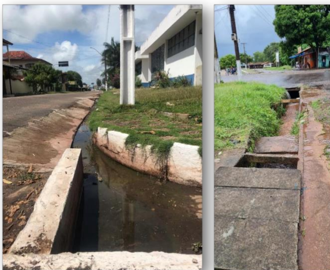
Figura 17– Infraestrutura das valas de escoamento da cidade de Soure.
