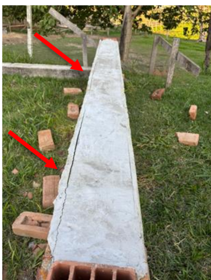
Figura 17 – Envergamento da fôrma com espaçamento 1 m entre os grampos metálicos.
