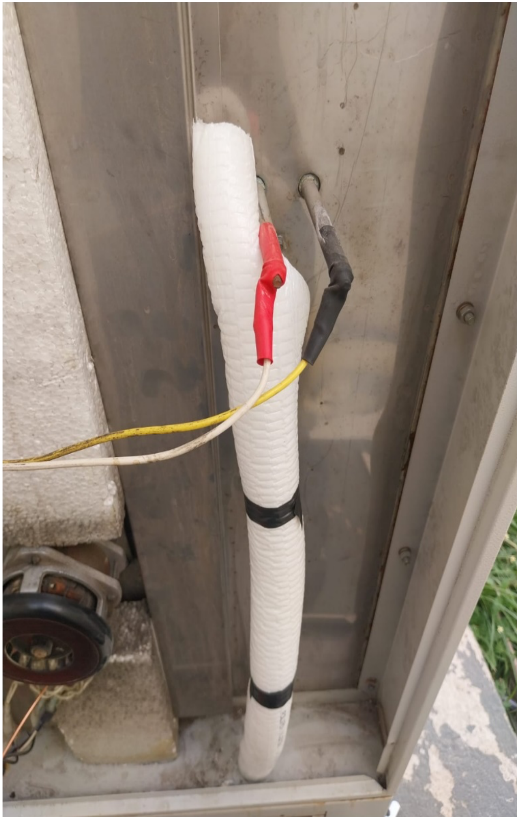
14. Figura 14: Tubulação da parte traseira
