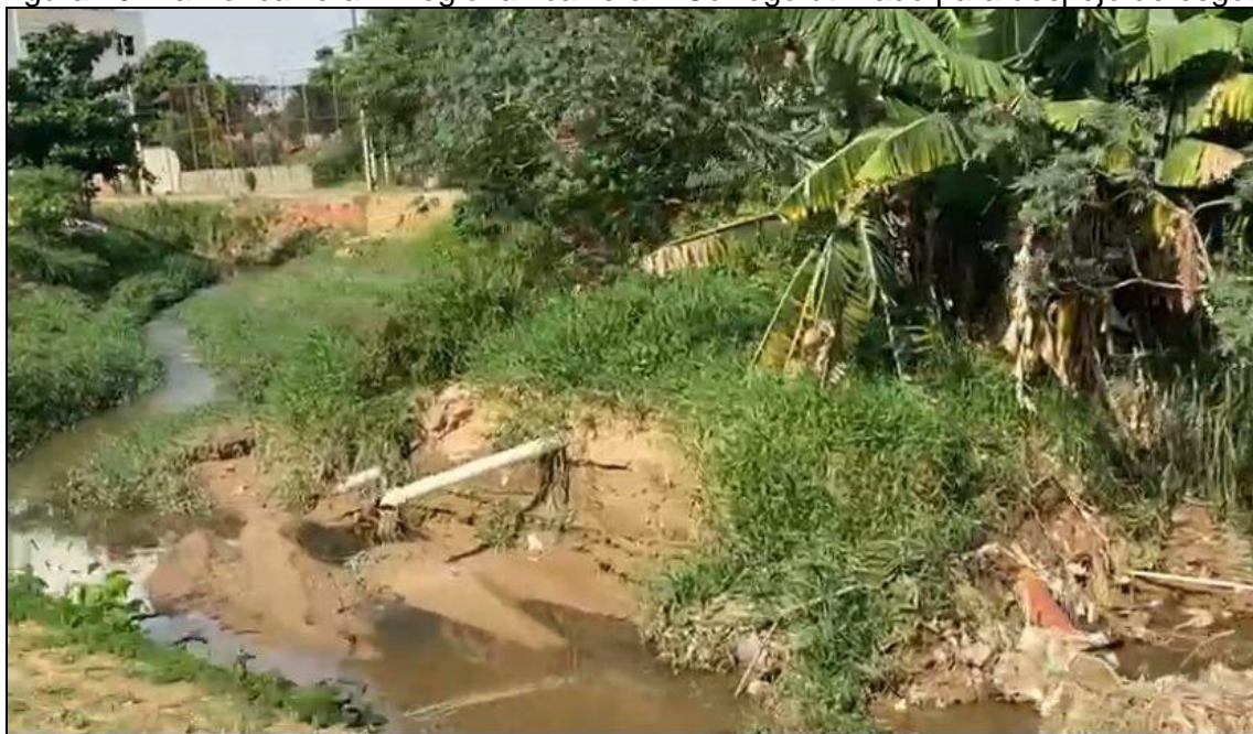
Figura 40: Bairro Icaivera – Regional Icaivera – Córrego utilizado para despejo de esgoto
