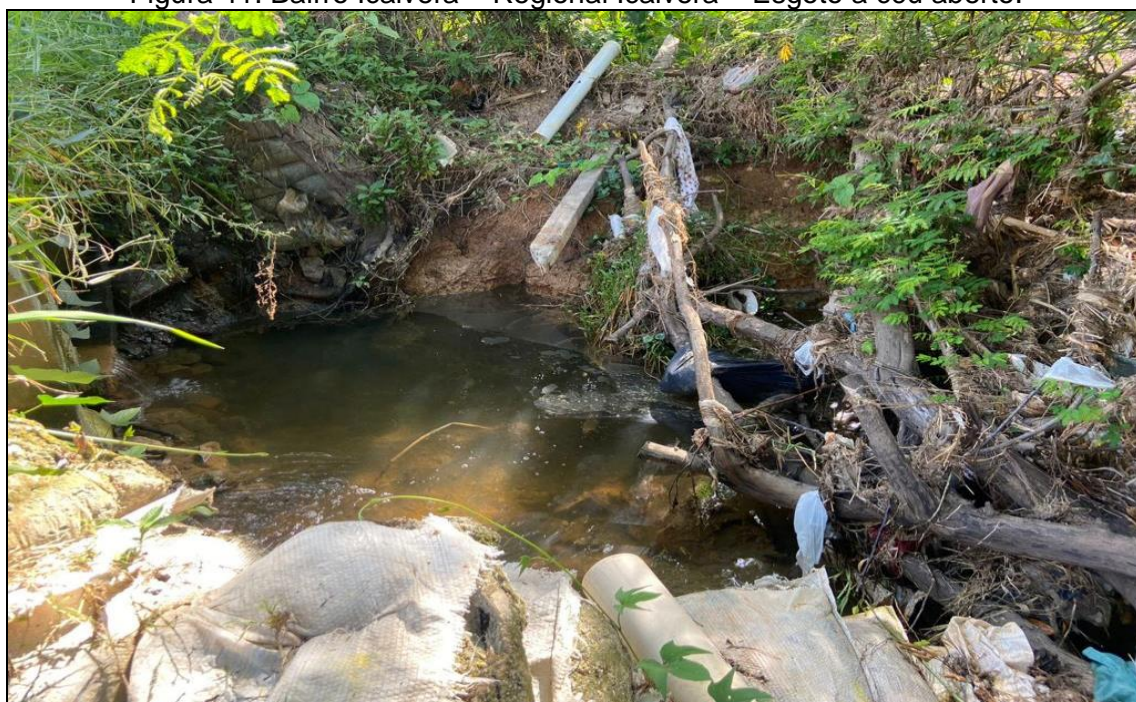
Figura 41: Bairro Icaivera – Regional Icaivera – Esgoto a céu aberto.
