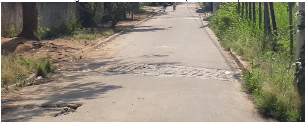
Figura 63 - Asfalto danificado (São Geraldo)
