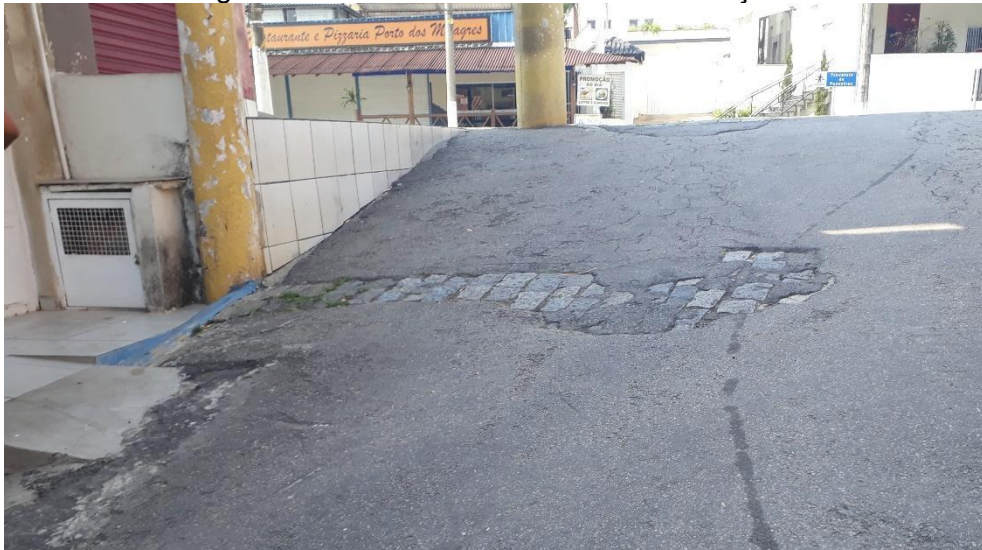
Figura 62 - Danos no asfalto e falta de calçada
