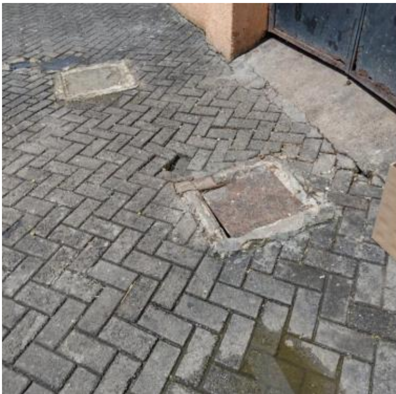
Figura 39: Tubulação e caixa de passagem do Mercado Municipal de São Jose dos Campos - Foto retirada do Laudo Fotográfico feito pela Prefeitura
